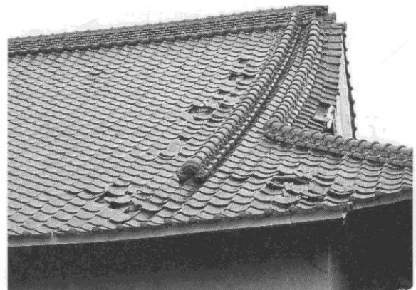
本堂屋根瓦破損の様子
